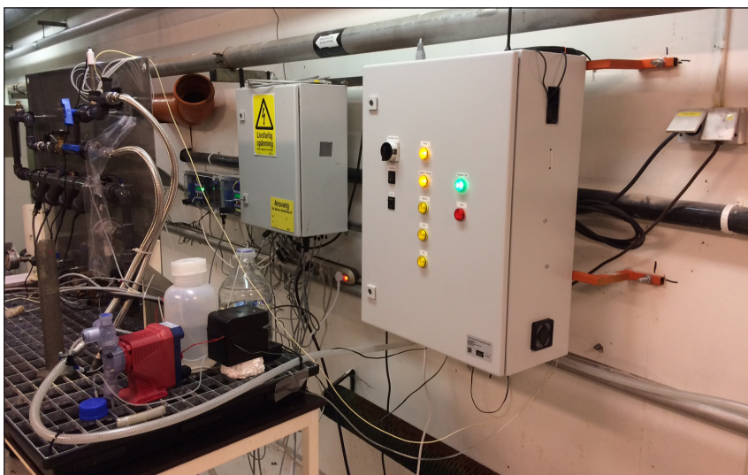
Figur 6.7 Instrumentprototyp installerad på Tekniska verken i Linköping för mätning på dricksvatten.
